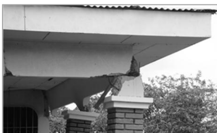
Vivienda afectada agosto 2011 - Fuente: el autor
